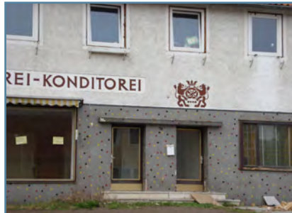
Viele Häuser wurden lange Zeit vernachlässigt. Verfall und hohe Leerstände sind die Folge.
